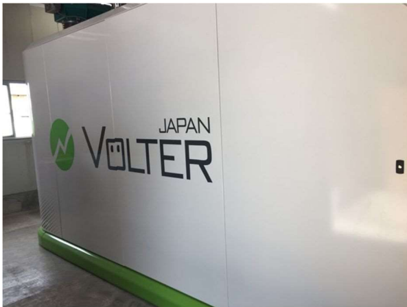
小型木質バイオマス発電機
