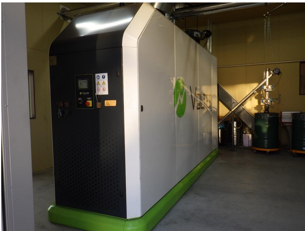
写真 3-7 渋川バイオマス研究所 導入している CHP
