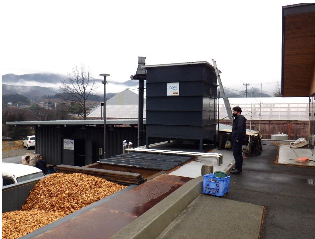
写真 3-12 ウッドビレジ川場 CHP 用チップ乾燥機
